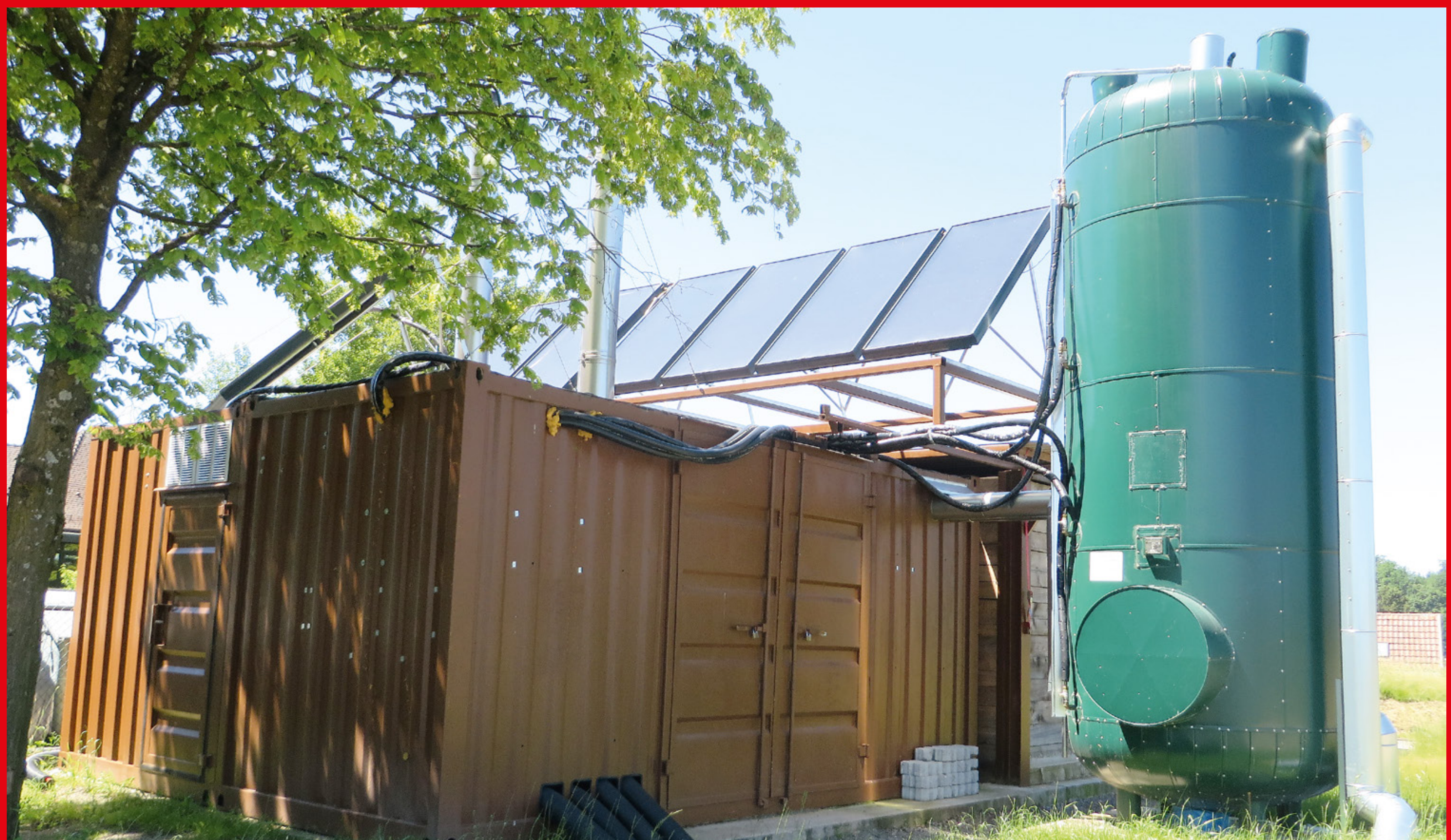
Heizzentrale Weißenbronn mit Solarthermieanlage.
